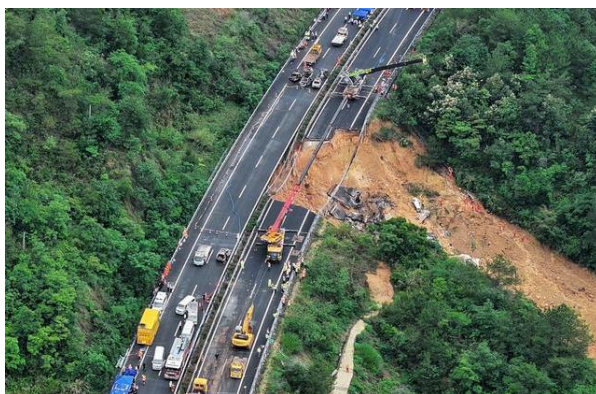
図10 梅大高速道路崩落現場の状況 (出典: 新華社)
