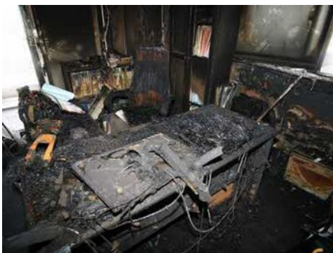
事務室の焼損状況
