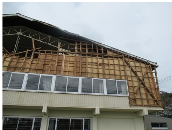
文教施設における外壁の破損（南房総市）
