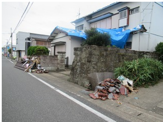
住宅における屋根の破損（鋸南町）
