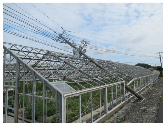
電柱の転倒（南房総市）
