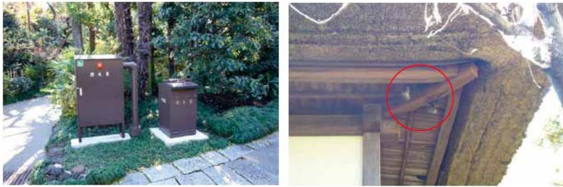
図2 屋外消火栓箱及び放水銃格納箱（左）、炎センサー（右） （出典：「重要文化財建築物等に対応した防火対策のあり方に関する報告書」 3) ）
