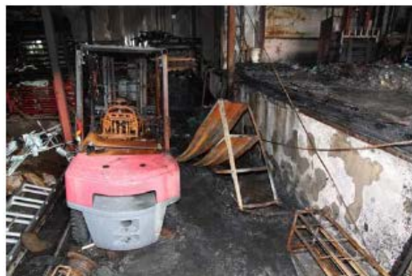
出火箇所付近の状況
