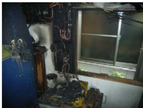
作業場内の分電盤付近の状況
