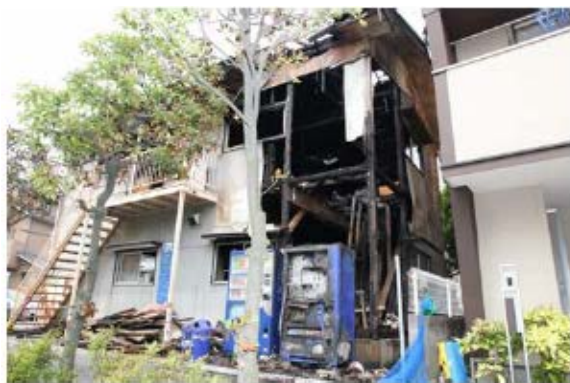
出火箇所付近の状況
