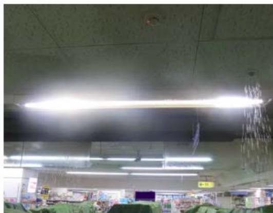
スプリンクラーの作動状況
