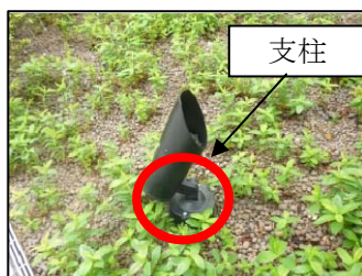
写真2 差込式照明の例
