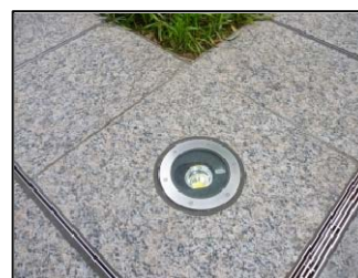
写真3 埋込式照明の例
