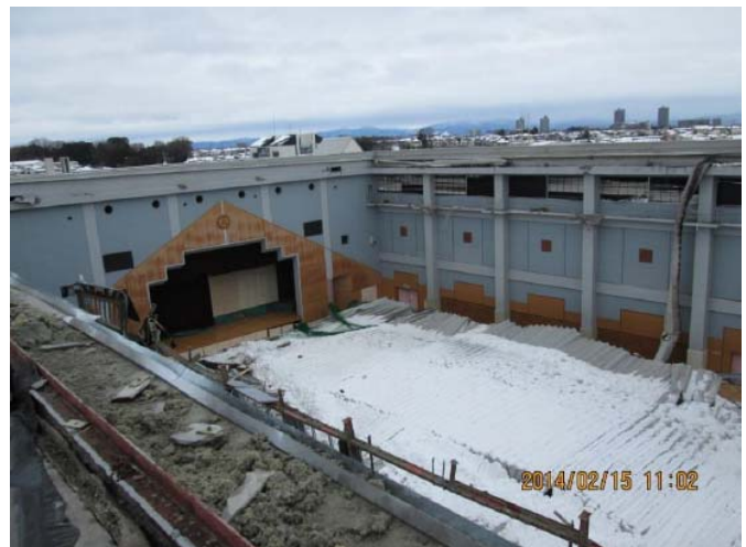
【屋根が崩落したメインアリーナ】
